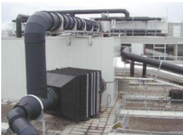
Die Abluftreinigungsanlage in der Rohwarenhalle wird auf Seuchenfall (Natronwäscher) gestellt
