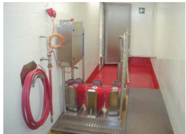
Reinigungsschleuse zwischen unreiner Seite (Rohwarenannahmestelle) und reiner Seite (Produktion)
