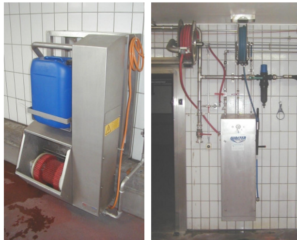
Die vorhandenen Reinigungsstellen werden mit Desinfektionsmittel versorgt
